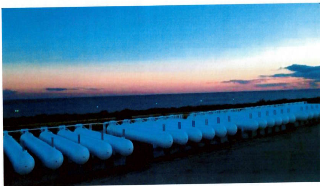
Figura 9 — Área de Armazenamento em Planta de GLP Fonte: Central propagas
