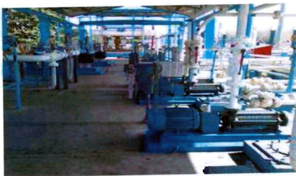
Figura 10 — Área de bombas e compressores Fonte: Central o Salitral
